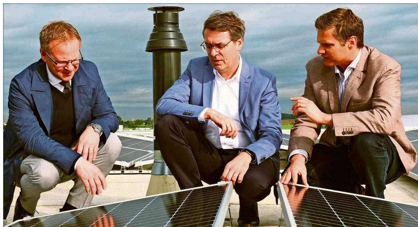
Die Fotovoltaikanlage auf dem erkennbar leicht windigen Dach der Ipco-Produktionshalle in Fellbach.
